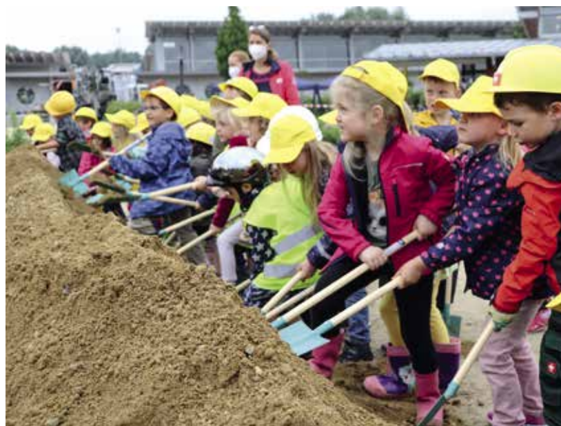
Kindergartenkinder beim ersten Spatenstich für den Erweiterungsbau des städtischen Kindergartens Maria Rast im Juli 2021. Bis September 2023 wird die Einrichtung um einen Hort, zwei Krippengruppen und weitere Räume zu einem „Haus für Kinder“ erweitert.
