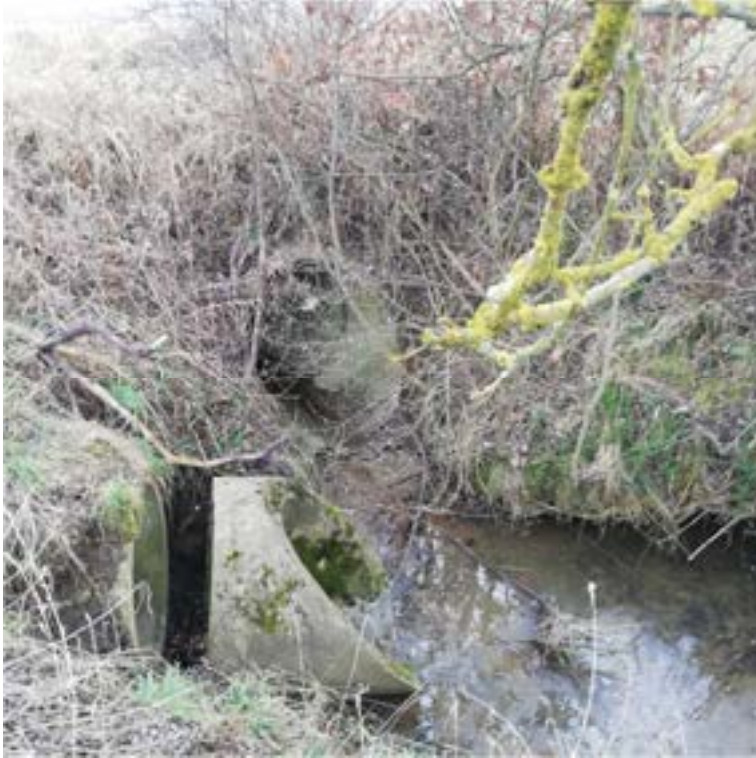
Abbildung 3-15: Schindelhauser Graben, Durchlass DN1000 und DN800 mit losem Böschungsstück
