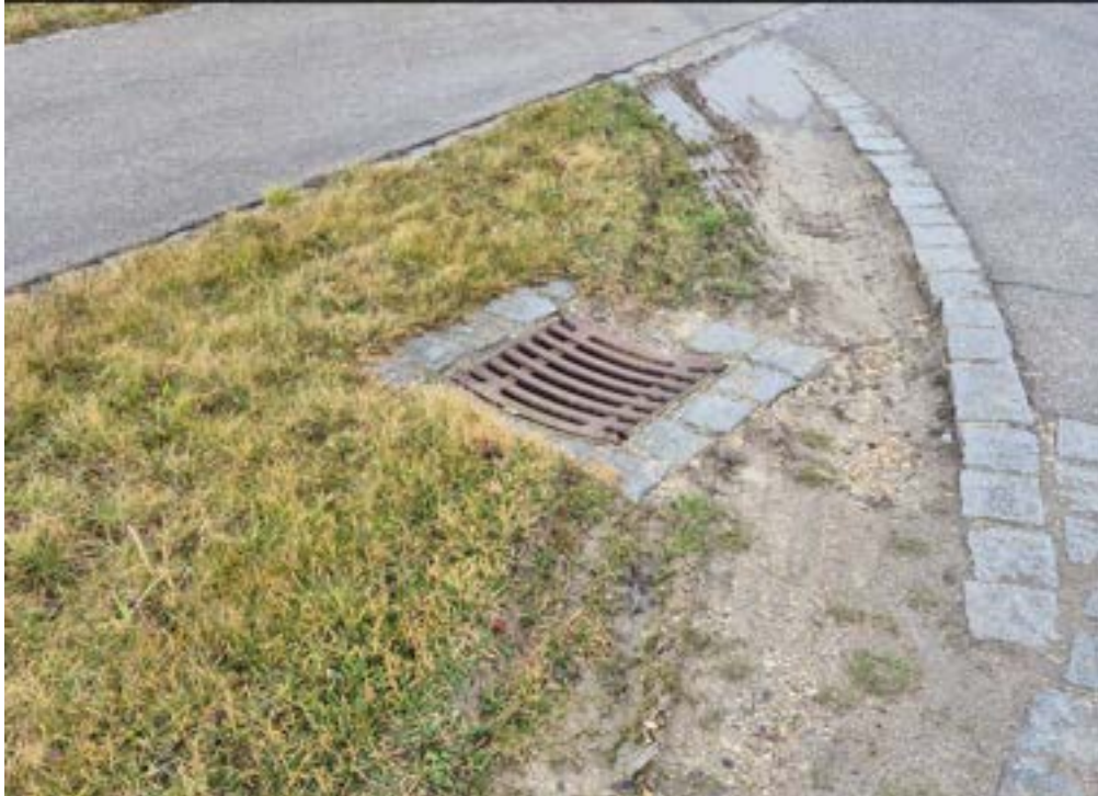
Abbildung 5-2: Gelände um SSK ist links zu hoch und rechts zu tief, Einlauf nicht möglich
