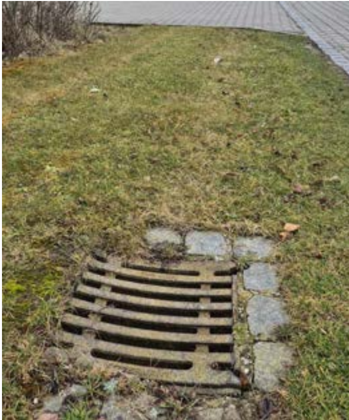
Abbildung 3-8: Mulden-Rigolenelement R3 in der Färberstr. mit Überlauf in den Kanal
