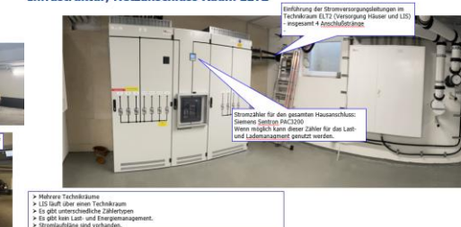
Bestandsaufnahme Infrastruktur; Netzanschluss Raum ELT2
